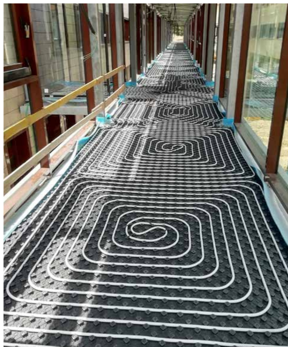
Riscaldamento a pavimento radiante
